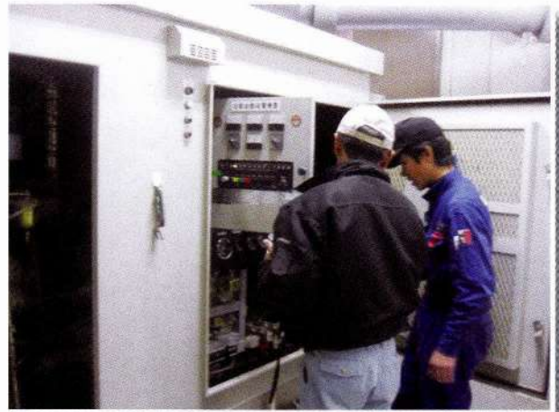
J棟非常用発電機の試運転
