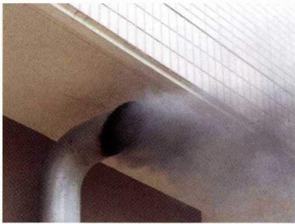
J棟非常用発電機 (試運転、開始時の排煙)
