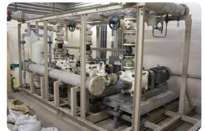
A棟横ポンプ室に配置された加圧ポンプ
